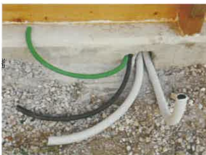
樹脂製配管(蒸気配管、給湯配管等)貫通箇所のシール
